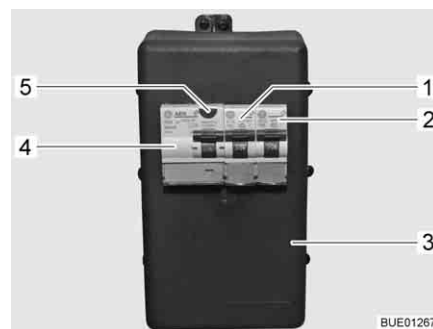
Bild 131 230 V-säkringslåda med ledningsskyddsbrytare och FI-brytare
