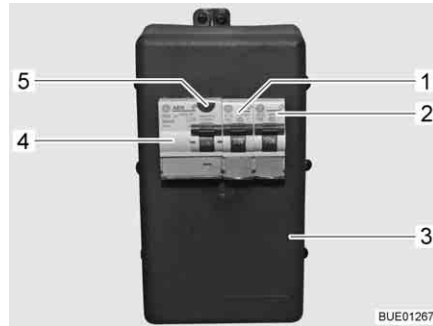
Kuva 123 230 V:n sulakerasia ja johdinsuojakytin sekä FI-kytkin
