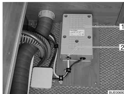
Kuva 152 Sähköisen lattialämmityksen muuntaja
