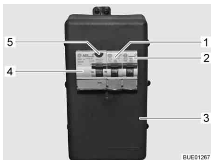
Kuva 131 230 V:n sulakerasia ja johdinsuojajytkin sekä FI-kytkin
