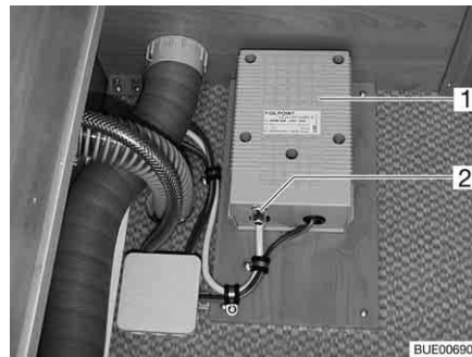
Kuva 197 Sähköisen lattialämmityksen muuntaja
