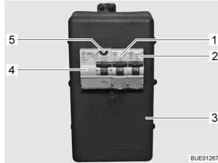
Kuva 167 230 V:n sulakerasia ja johdinsuojakytkin
