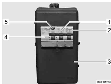
Bild 167 230-V-Sicherungskasten mit Leitungsschutzschalter und FI-Schalter
