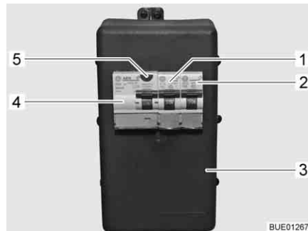
Bild 177 230-V-Sicherungskasten mit Leitungsschutzschalter und FI-Schalter
