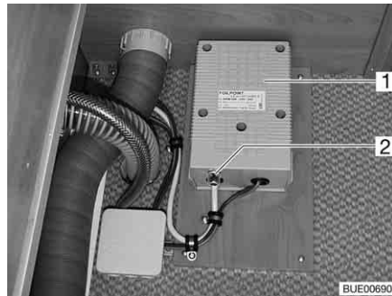
Afb. 197 Transformator voor de elektrische vloerverwarming
