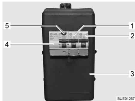
Afb. 177 230-V-zekeringenkast met beveiligingsautomaat en FI-schakelaar
