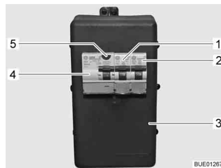
Afb. 167 230-V-zekeringenkast met beveiligingsautomaat en FI-schakelaar
