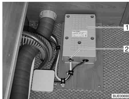
Bild 173 Transformator för elektrisk golvvärme
