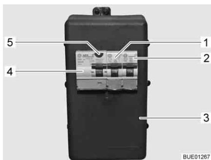
Bild 152 230 V-säkringslåda med ledningsskyddsbrytare och FI-brytare
