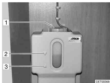
Fig. 252 Vase d'expansion pour le chauffage à eau chaude
