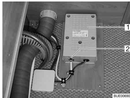
Billede 173 Transformator for elektrisk gulvopvarmning
