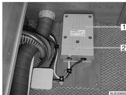
Bild 173 Trafo für elektrische Fußbodenerwärmung
