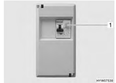
Kuva 146 230 V:n sulakerasia sekä johdin- ja vikavirtasuojakatkaisin (FI)
