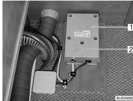
Kuva 166 Sähköisen lattialämmityksen muuntaja
