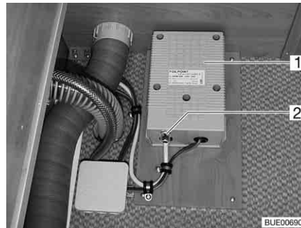
Bild 137 Trafo für elektrische Fußbodenerwärmung
