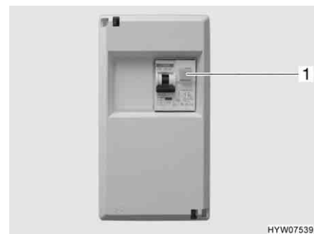
Bild 117 230-V-Sicherungskasten mit Leitungs- und Fehlerstrom-Schutzschalter (FI)
