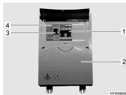
Fig. 48 Scatola dei fusibili a 230 V con interruttore di sicurezza e interruttore automatico FI
