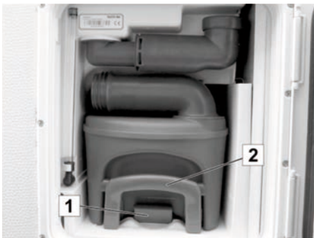
Abb. 142: Fäkalientank im Entsorgungsschacht
