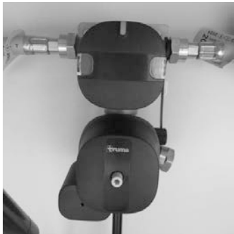
Abb. 79: Gasversorgung (mit Eis-Ex und Fernanzeige)
