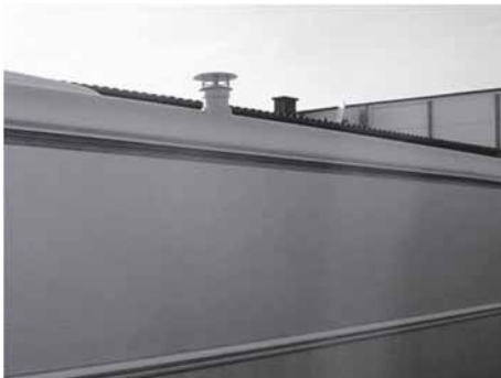
Fig. 82: Avgassrør for gassvarmen
