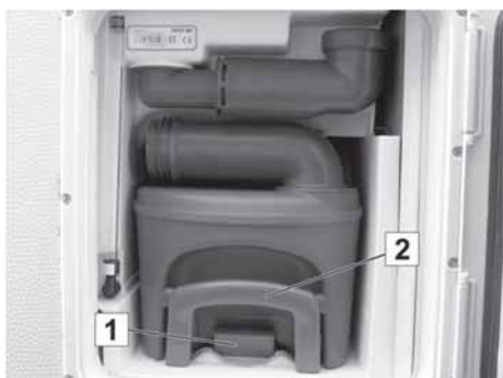
Fig. 200: Kloakktank i avfallsjakten
