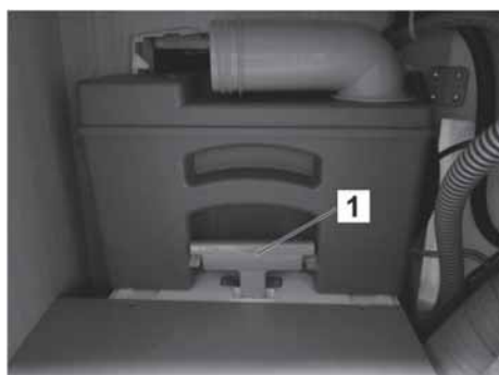
Fig. 203: Kloakktank i avfallsjakten
