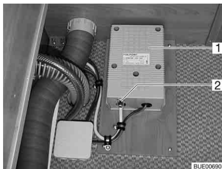
Kuva 205 Sähköisen lattialämmityksen muuntaja
