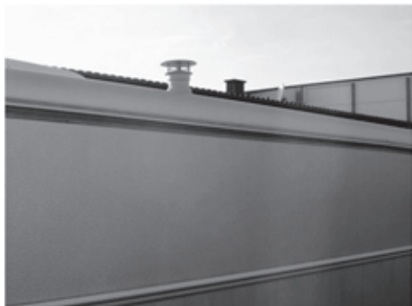
Afb. 78: Schoorsteen voor verbrandingsgassen van de gasverwarming
