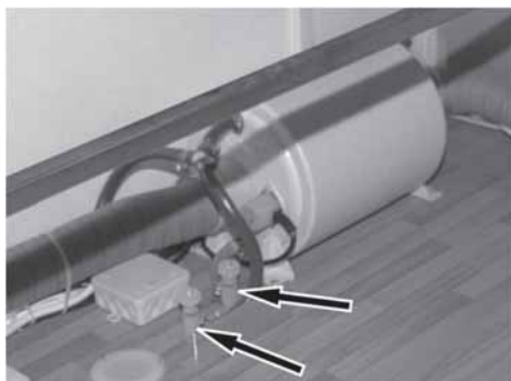
Fig. 113: Vannes de vidange
