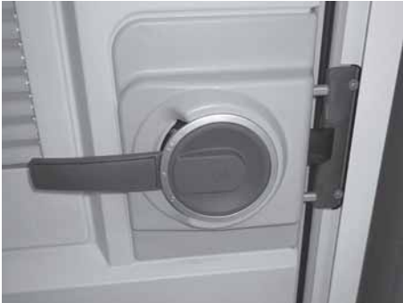
Fig. 13: Serrure de porte fermée mais non sécurisée
