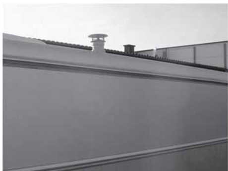
Fig. 74: Conduit d'évacuation des gaz brûlés du chauffage à gaz
