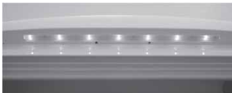
Fig. 65 : Eclairage de l'auvent à diodes électroluminescentes
