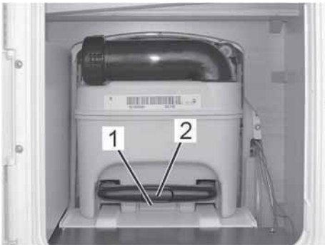
Fig. 123: Kloakktank i avfallsjakten
