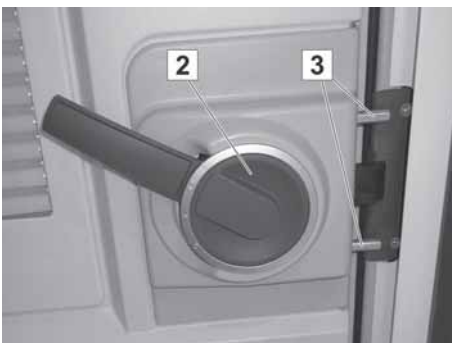
Fig. 15: Dør lukket og sikret
