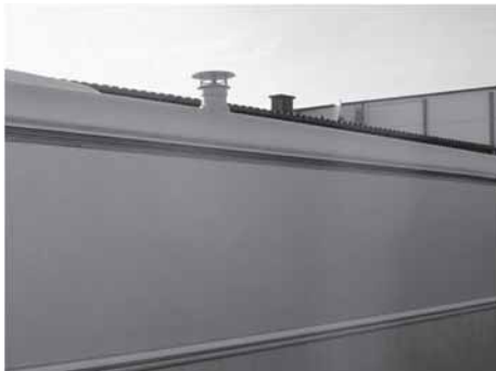
Fig. 74: Avgassrør for gassvarmen
