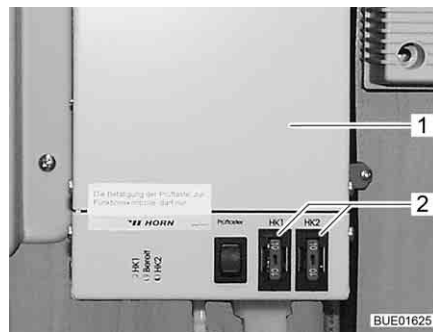
Fig. 129 Regulador de la calefacción para las tuberías de aguas residuales
