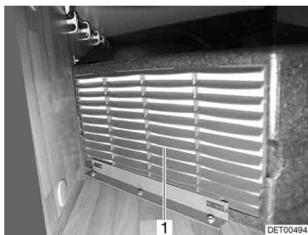
Fig. 196 Impianto di climatizzazione (Truma)
