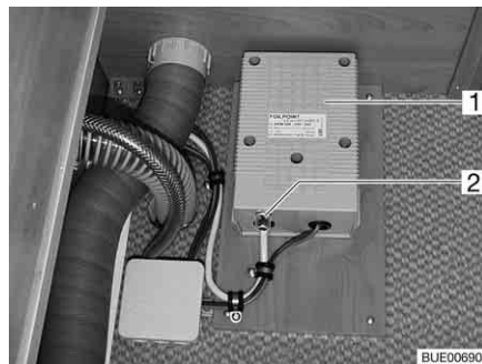
Afb. 143 Transformator voor de elektrische vloerverwarming
