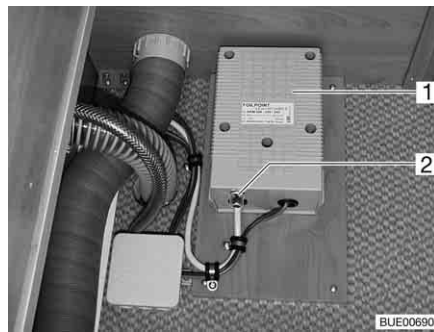
Bild 148 Transformator för elektrisk golvvärme
