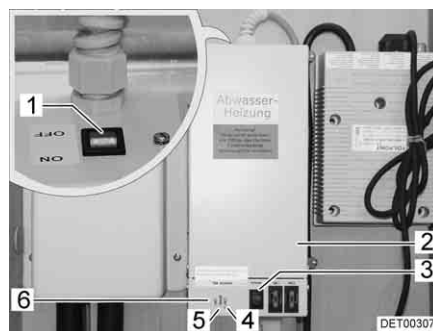
Billede 147 Transformator med reguleringsapparat
