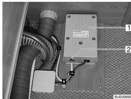
Billede 148 Transformator for elektrisk gulvopvarmning
