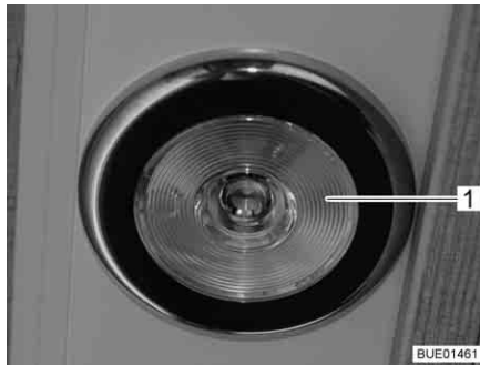
Billede 44 Indbygget lampe, lyskontakt i lampen
