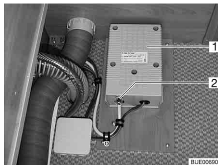
Afb. 148 Transformator voor de elektrische vloerverwarming
