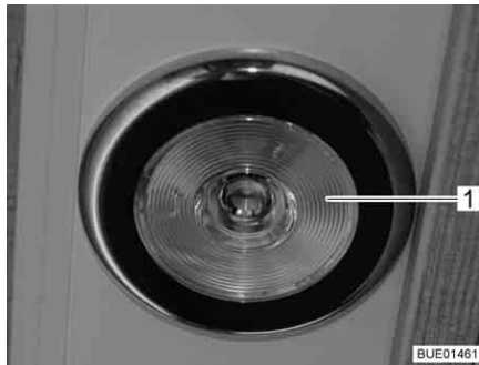
Bild 44 Infälld lampa, ljusbrytare i lampan
