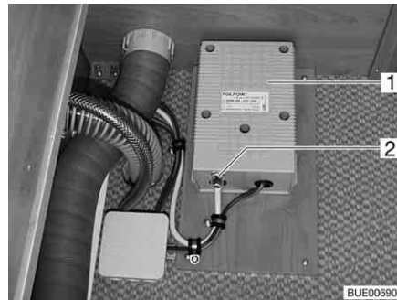
Afb. 117 Transformator voor de elektrische vloerverwarming
