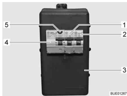
Afb. 99 230-V-zekeringenkast met beveiligingsautomaat en FI-schakelaar
