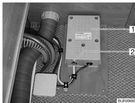
Bild 119 Transformator för elektrisk golvvärme
