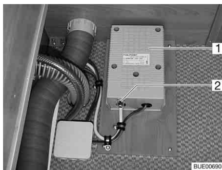
Billede 119 Transformator for elektrisk gulvopvarmning
