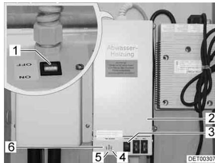
Billede 118 Transformator med reguleringsapparat
