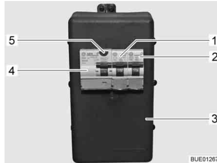
Billede 101 230 V-sikringskab med sikkerhedsafbryder og HFI-afbrydere
