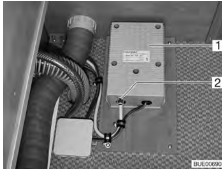
Billede 124 Transformator for elektrisk gulvopvarmning
