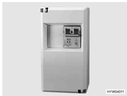
Bild 104 230-V-Sicherungskasten mit Leitungsschutzschalter
