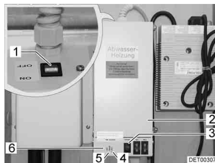
Bild 122 Trafo mit Regelgerät
