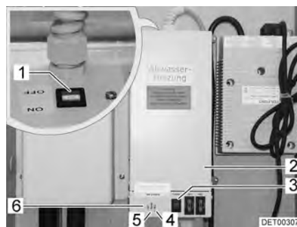
Billede 122 Transformator med reguleringsapparat
