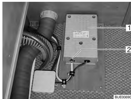
Billede 123 Transformator for elektrisk gulvopvarmning
