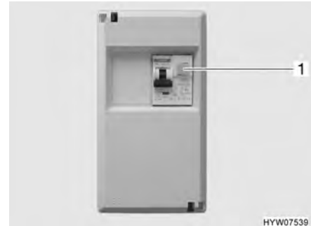
Bild 105 230-V-säkringslåda med lednings- och jordfelsbrytare (FI)
