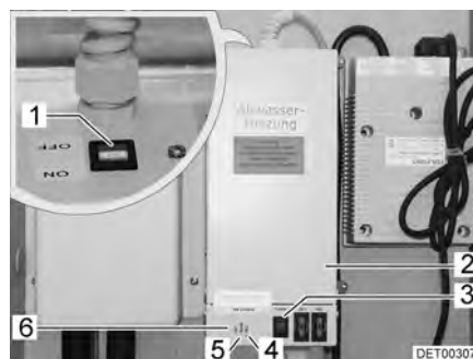
Bild 122 Transformator med regulator
