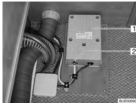
Bild 123 Transformator för elektrisk golvvärme
