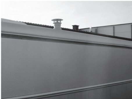
Abb. 83: Abgaskamin der Gasheizung
