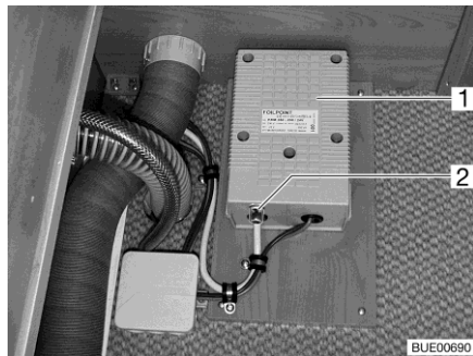
Bild 224 Trafo für elektrische Fußbodenheizung
