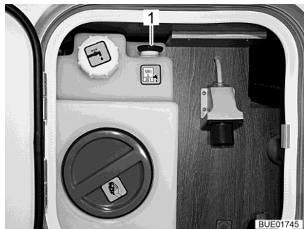
Fig. 279 Réservoir d'eau (unité de service)
