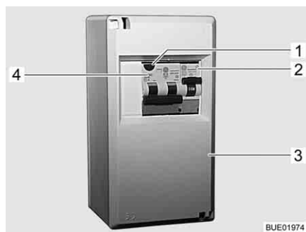
Fig. 184 Scatola dei fusibili a 230 V
