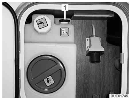
Bild 247 Vattentank (central försörjningsenhet)
