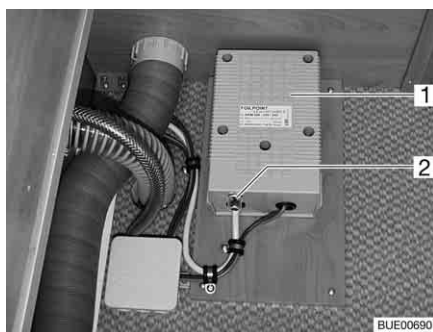
Kuva 209 Sähköisen lattialämmityksen muuntaja
