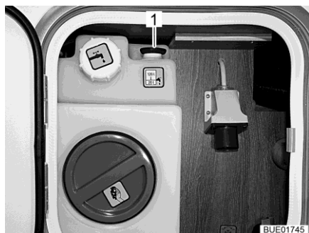
Fig. 177 Serbatoio dell'acqua (unità di servizio)
