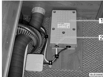
Kuva 168 Sähköisen lattialämmityksen muuntaja
