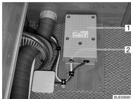
Billede 168 Transformator for elektrisk gulvopvarmning
