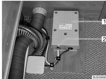
Bild 168 Transformator för elektrisk golvvärme
