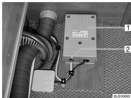
Fig. 168 Transformateur du chauffage électrique du plancher
