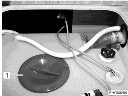
Fig. 280 Ouverture de nettoyage du réservoir d'eau
