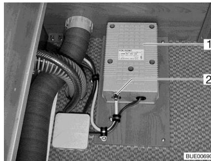
Billede 223 Transformator for elektrisk gulvopvarmning
