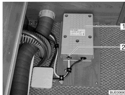
Bild 120 Transformator för elektrisk golvvärme
