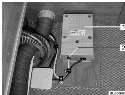
Afb. 120 Transformator voor de elek- trische vloerverwarming
