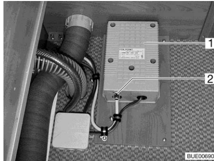
Kuva 223 Sähköisen lattialämmityksen muuntaja
