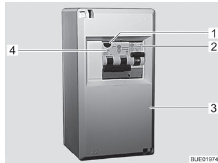
Fig. 127 Coffret de fusibles 230 V
