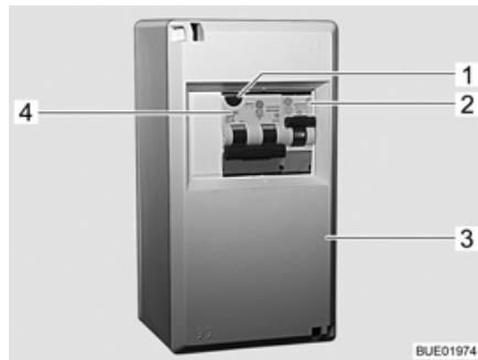
Kuva 141 230 V:n sulakerasia ja johdinsuojakytkin sekä FI-kytkin
