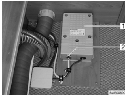
Kuva 166 Sähköisen lattialämmityksen muuntaja
